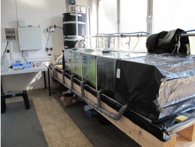
Abbildung 4: Bypass-Anlage mit Sedimentationsbecken (links) und fünf Aquarien. Station liegt an der Schussen unterhalb der KA Langwiese.
